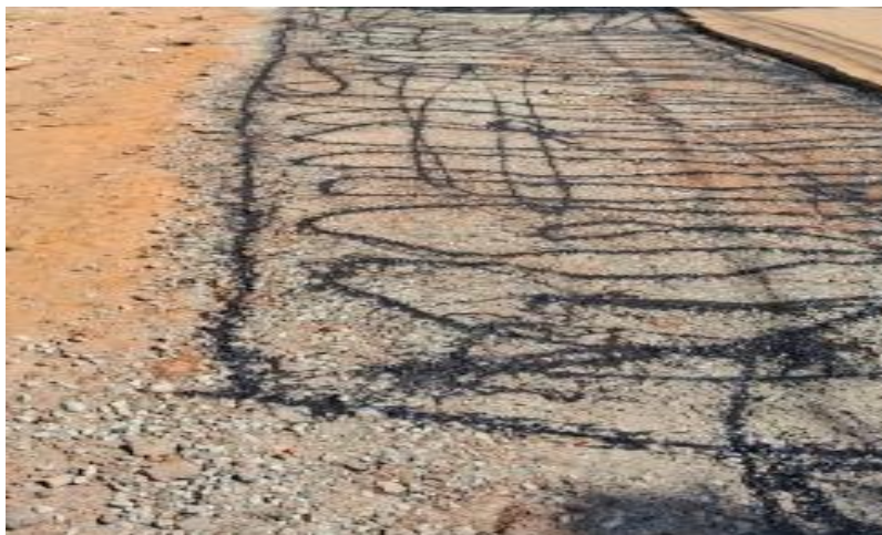
Pintura de ligação aplicada de forma irregular.
