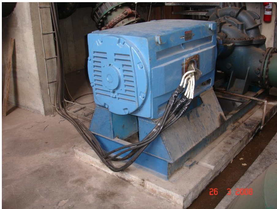
Foto B: Detalhe da base de alvenaria e base do conjunto (lado do motor)
